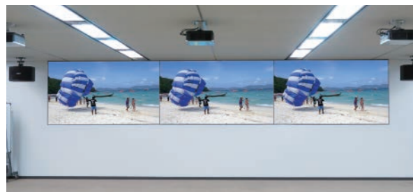
国内某外食チェーン会議室 100インチ(16:9)×3面
