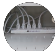
電源コンセント
