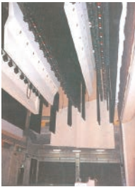
吊物設備上部全景
