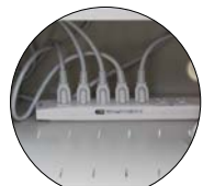
電源コンセント
